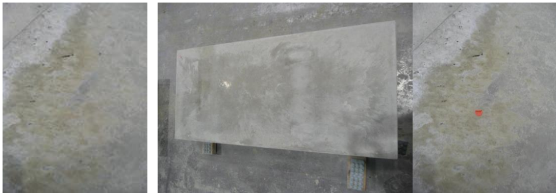
Figuur 5.18 Een teveel aan olie kan bruinachtige vlekken achterlaten op het beton. Dan ligt er een nieuw materiaal aan het oppervlak dat de kleur bepaalt.
