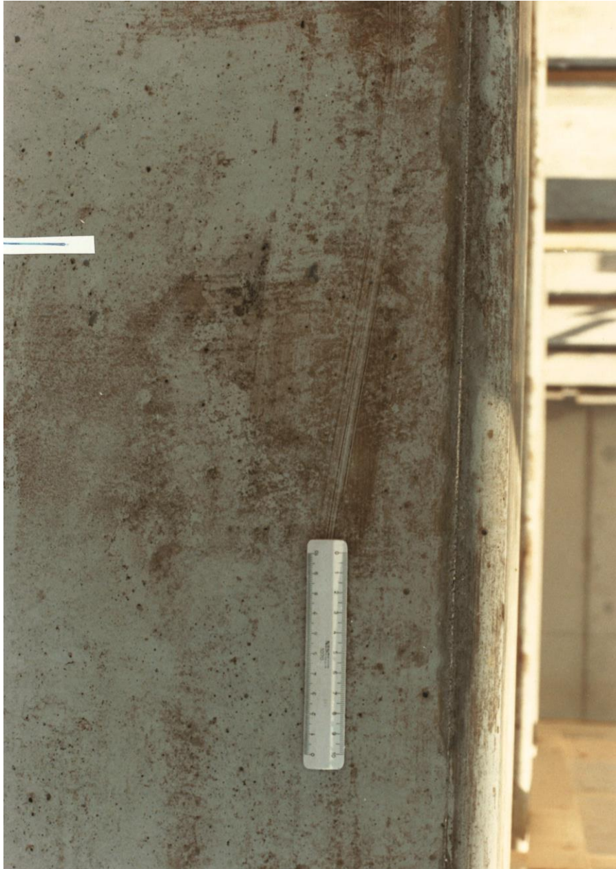
Figuur 5.31 Kleurverschil, als gevolg van vervuilde bekisting.
