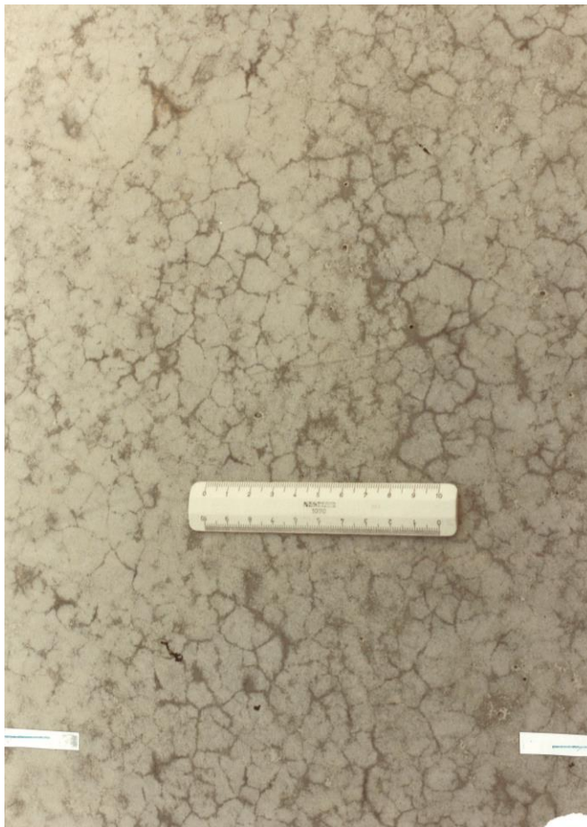
Figuur 5.25 Craquelé is een grillig netwerk van fijne, ondiepe scheurtjes.
