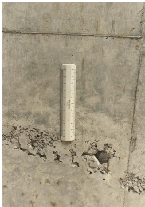
Figuur 5.34 Holle ruimtes als gevolg van onvoldoende verdichting met grindnesten tot gevolg.
