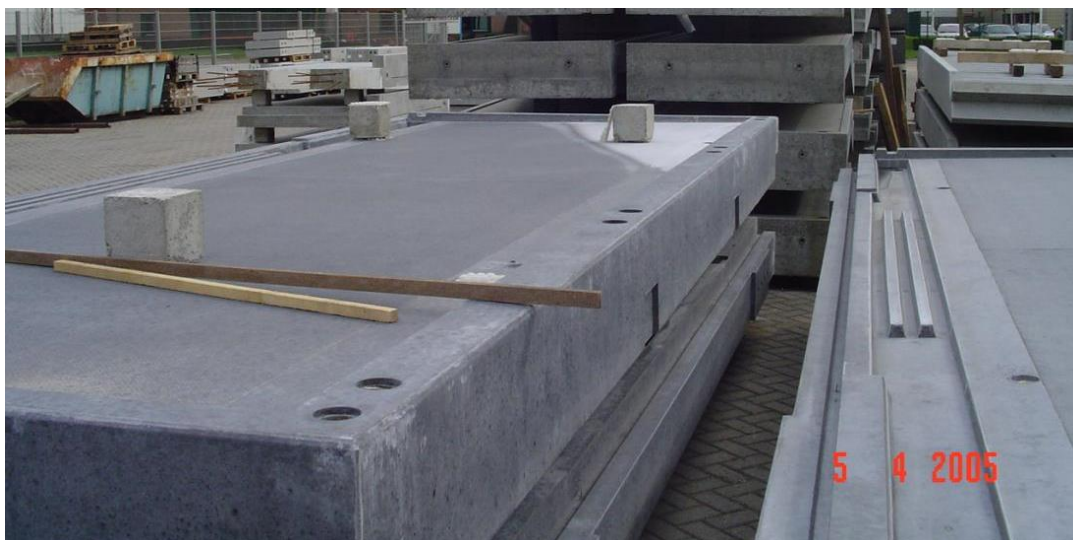
Figuur 5.37 Witte uitslag; er heeft lang water gestaan op dit antraciet betonelement.
