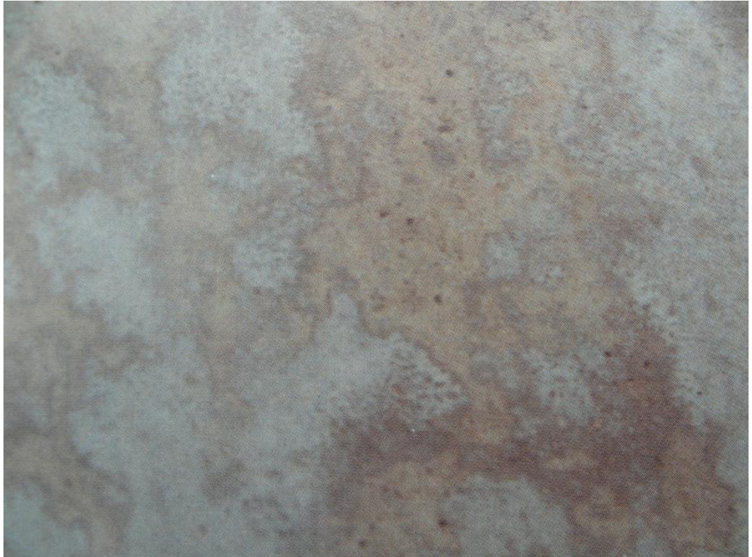
Figuur 5.32 Kleurverschil als gevolg van plaatselijk teveel ontkistingsolie.
