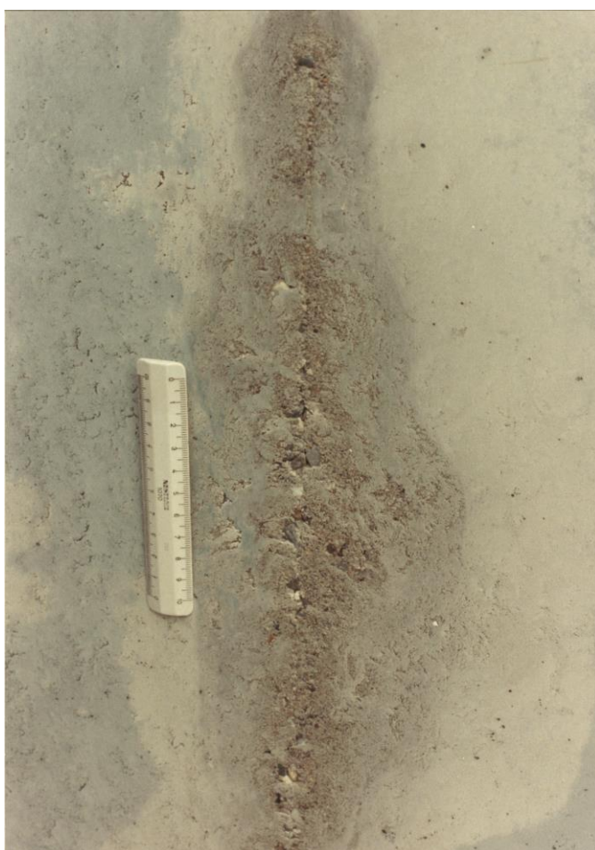
Figuur 5.35 Lekkende bekisting.
