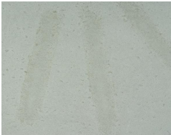
Figuur 5.14 Invloed van stophout op de kleur van beton. Een 3-tal latjes zijn na het ontkisten op het proefstuk gelegd. Basissamenstelling: wcf = 0,50, CEM III/B, schoon rivierzand 0/4.
